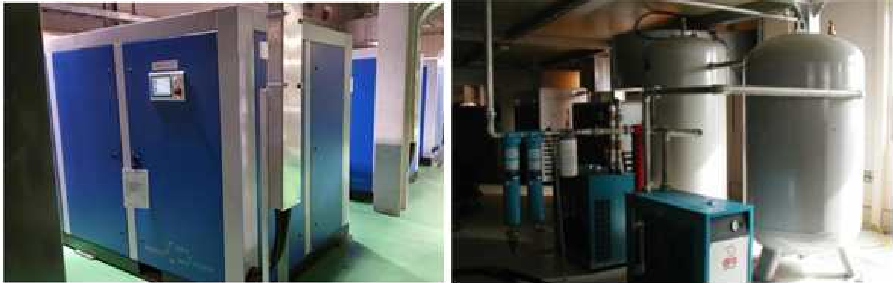
< 식품용 공기 압축기(Air Compressors) 설치 사례 >
